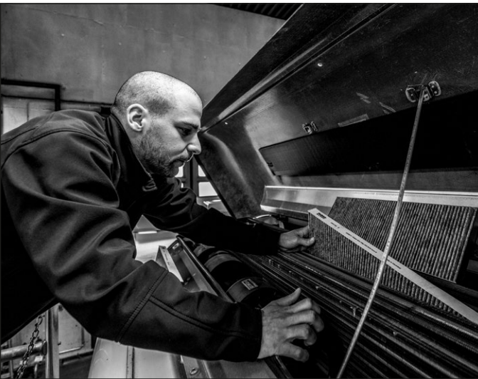
Die Filter der Klimaanlage müssen ohnehin regelmäßig gewechselt werden. So kommen die neuartigen Filter ohne Zusatzaufwand in die SSB-Busse.
